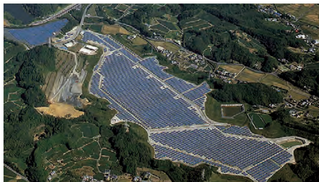
スズキ牧之原太陽光発電所
