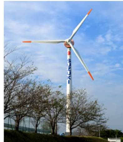
湖西工場 風力発電施設
