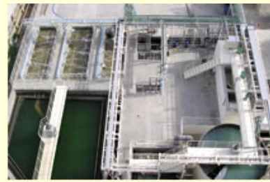
2007年6月に増設・稼動開始した排水処理
