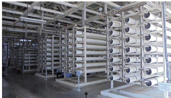
RO膜ろ過装置
